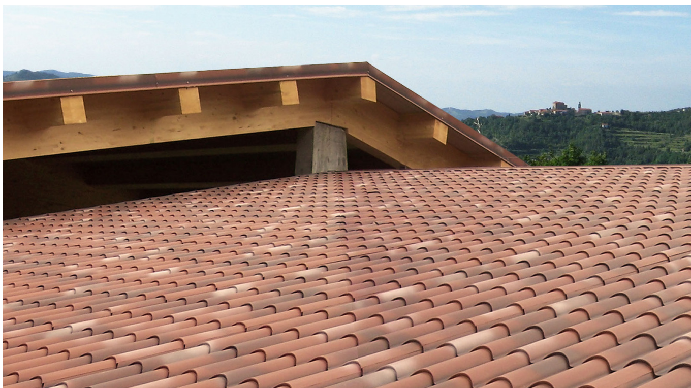
Toiture de bâtiment résidentiel en panneau SUPERCOPPO vieilli. Residential building roof made with antiqued SUPERCOPPO panel.
