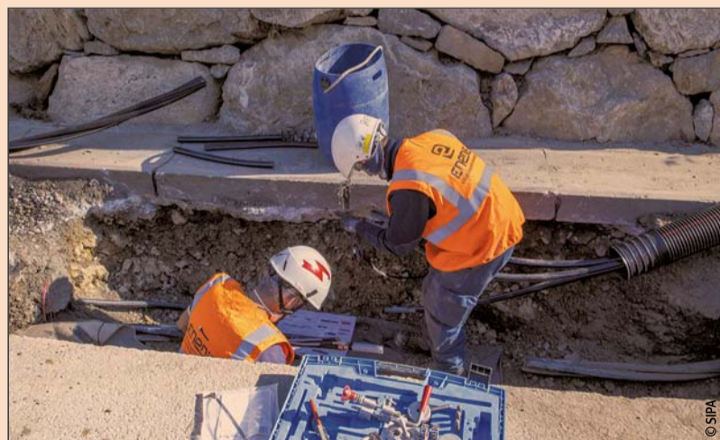
Enedis s'engage aussi à raccourcir les délais de réalisation de ses travaux sur la chaussée et sur les trottoirs.
